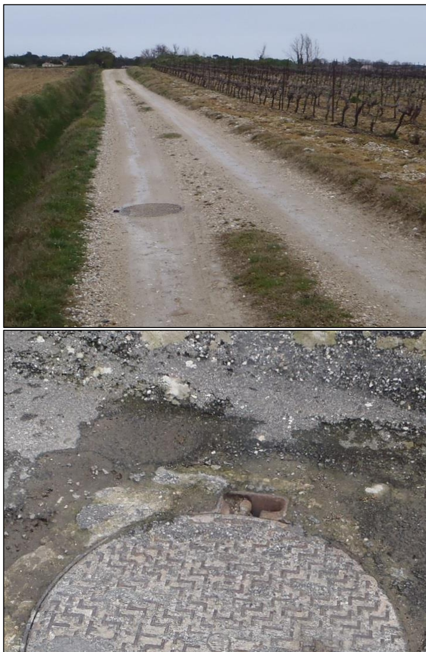
Illustration n°14: tampon non étanche en zone de ruissellement
