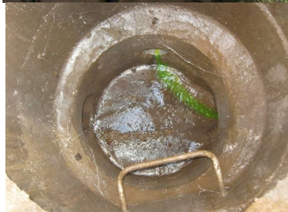
1 - Validation de la connexion hydraulique à l'aide d'un colorant
