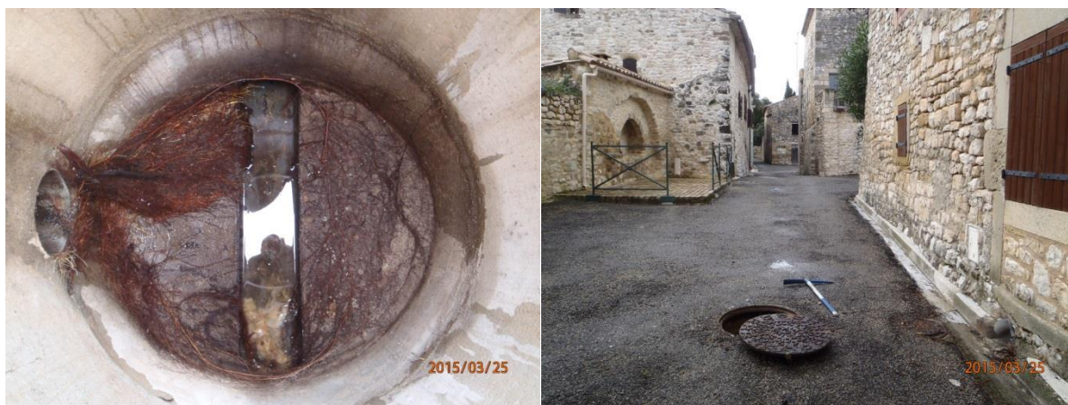
Illustration n°6 : Racines avec infiltrations d'ECP au RV n°27, rue du four à Garrigues
