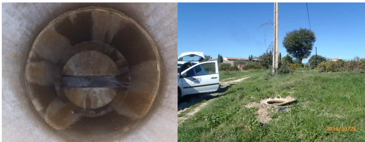
Illustration n°4 : Infiltrations par virole dans RV n°128, chemin de la Privadière à Sainte Eulalie
