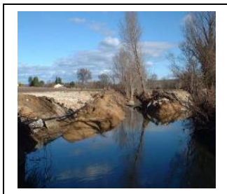
Erosions de berges au droit du remblai de la voie ferrée de Gajan (photo BCEOM)
